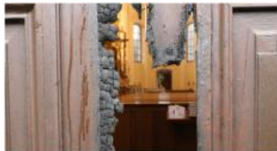
HOHER SACHSCHADEN: Nicht nur die Türen, auch der Innenraum könnte teilweise beschädigt sein.
