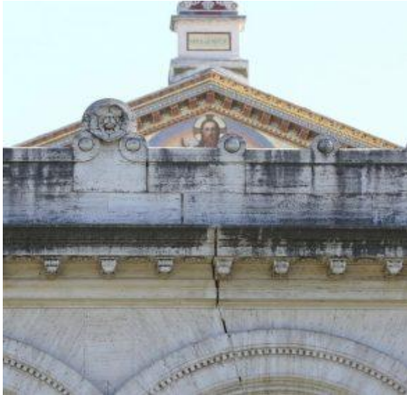
Einige Schäden sind mit freiem Auge zu erkennen, so an der großen Säulenhalle vor der Basilika
