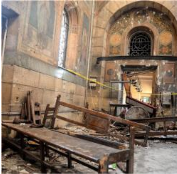
Große Schäden in der koptischen Kirche in Kairo - Quelle: dpa/EPA
